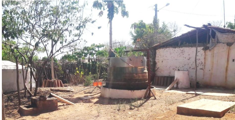
Figure 6 – Digester in Trapiá, Massapê, Ceará.
